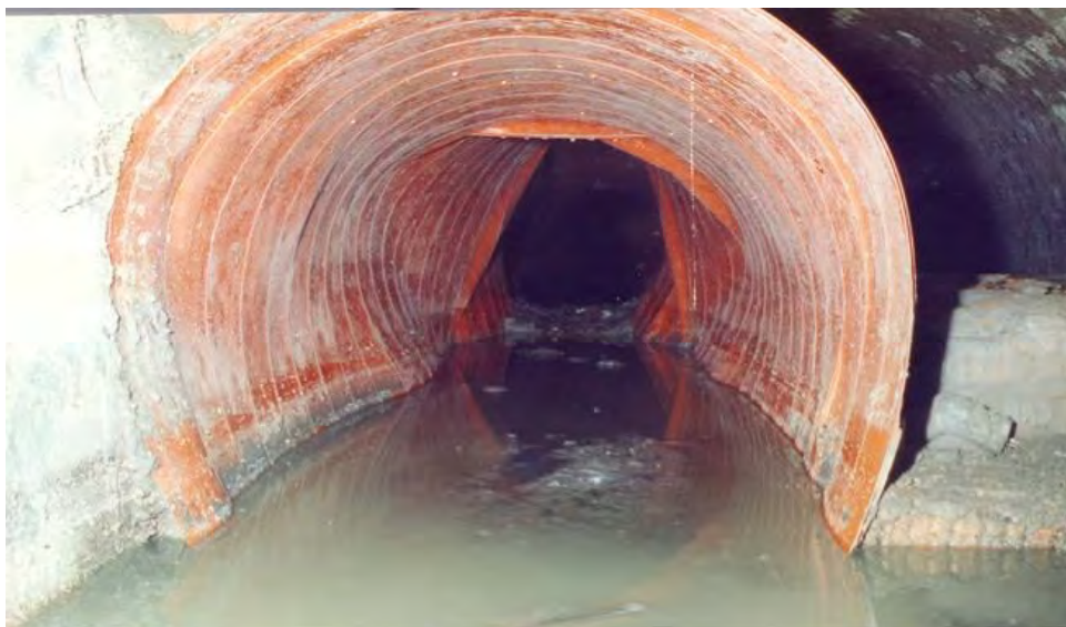
Obr. 4: Nepovedená realizace sanace, potrubí vytvořené spirálově vinutým pásem
