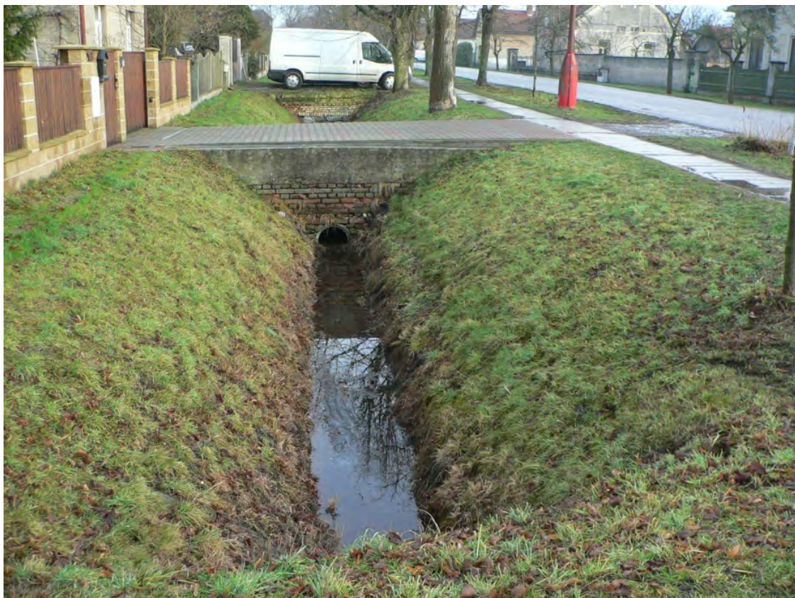
Obr. 5 – Příklad nechráněného odvodňovacího rigolu místní komunikace proti pádu v blízkém prostoru běžně se pohybujících osob (zdroj: vlastní).
